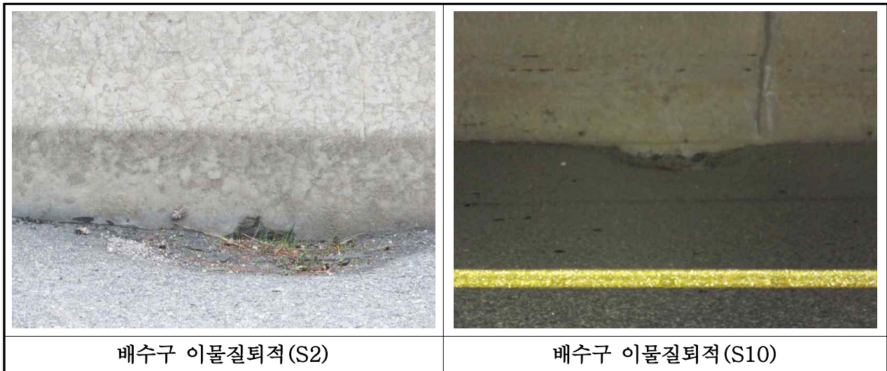
【사진 3.18】 배수시설 손상현황(내서)
