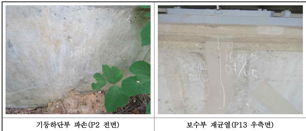
【사진 3.9】 교대 및 교각 손상현황(내서, 계속)
