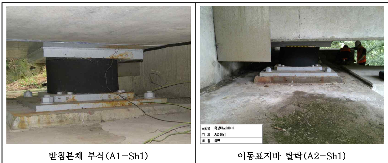
【사진 3.11】 교량받침 손상현황(내서)
