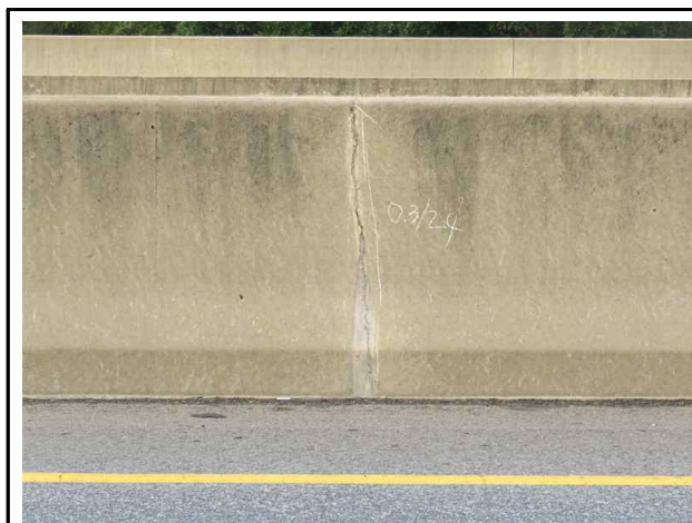
폭 0.3mm 균열(S4 우측방호벽)
