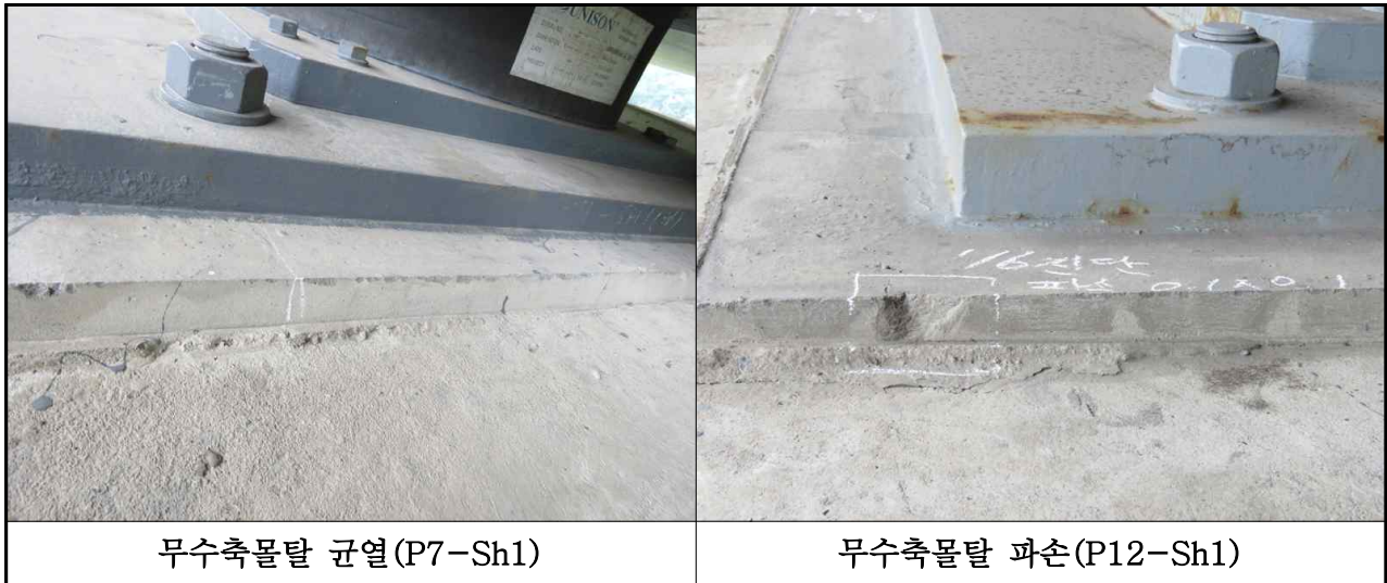
【사진 3.11】 교량받침 손상현황(내서,계속)
