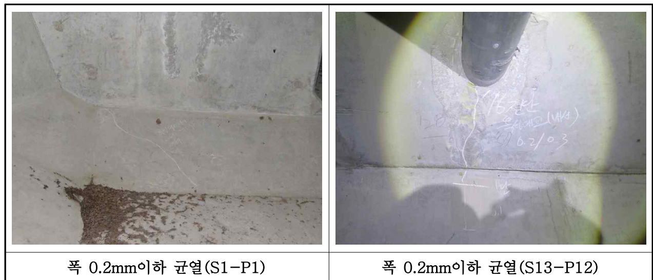
【사진 3.7】 격벽 손상현황(내서)
