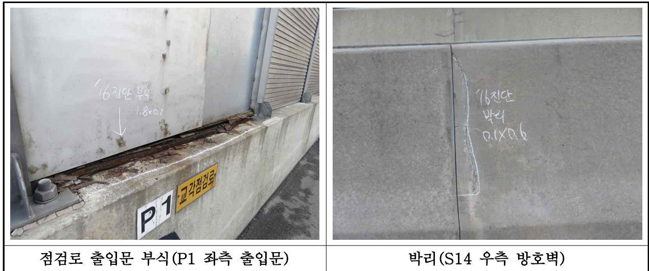
【사진 3.39】 난간 및 연석 손상현황(여주, 계속)
