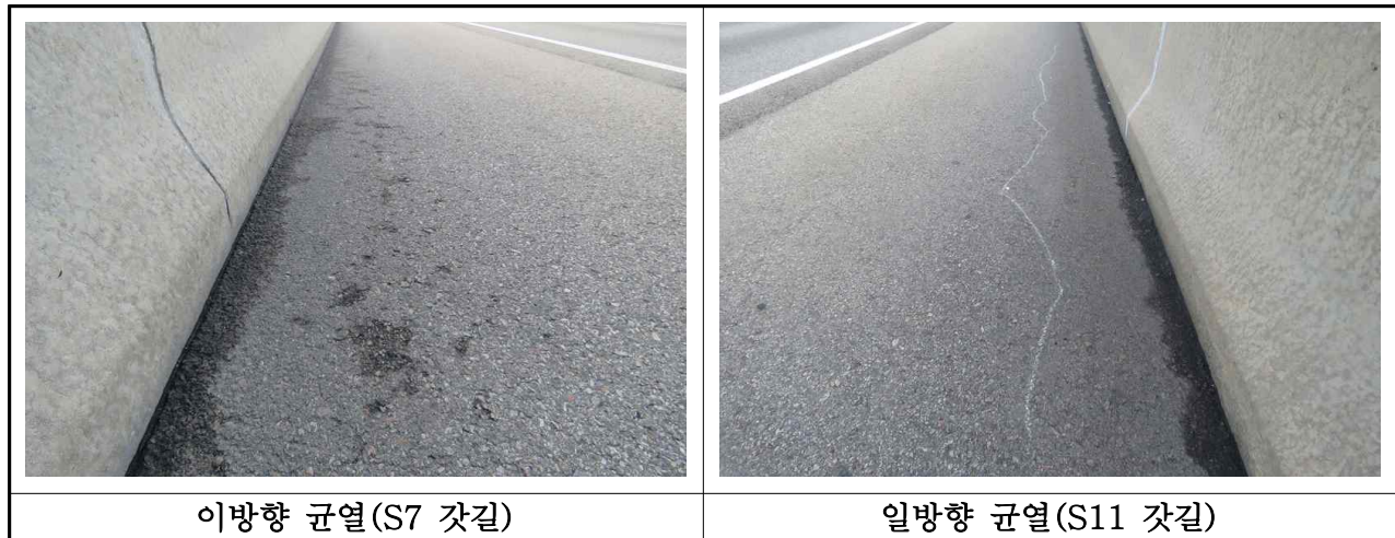
【사진 3.35】 교면포장 손상현황(여주)
