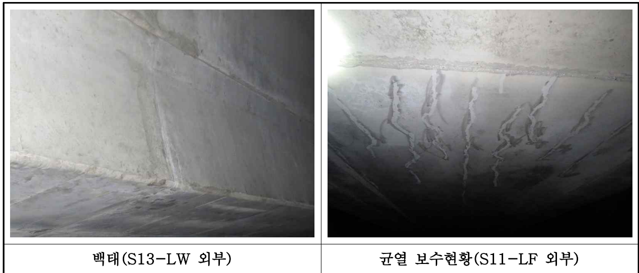
【사진 3.24】 거더 손상사진(여주, 계속)
